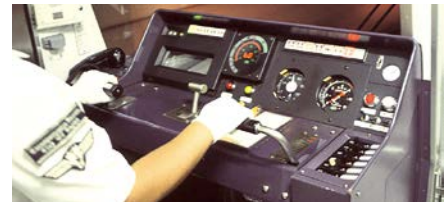
ATC (自動列車制御装置)
