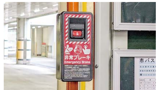
緊急停止ボタン
