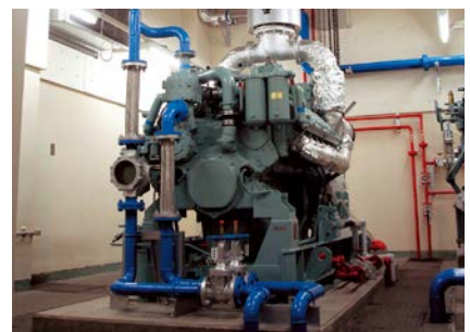
非常用発電機
