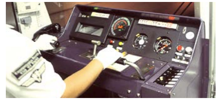
ATC (自動列車制御装置)
