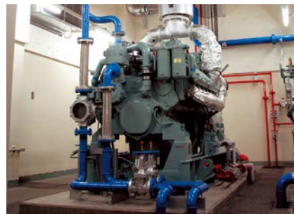
非常用発電機
