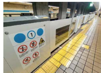
■ 鶴舞線可動式ホーム柵 (庄内緑地公園駅)
