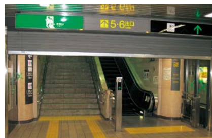
防火防煙シャッター
