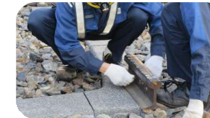
電気設備点検
