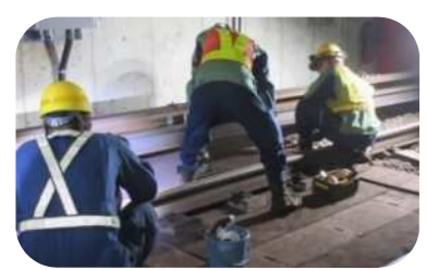
電気設備点検
