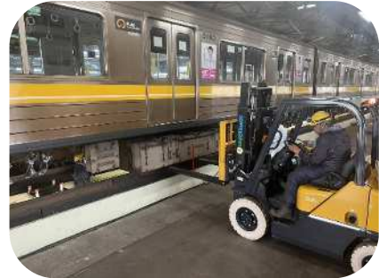
主要電気機器更新
