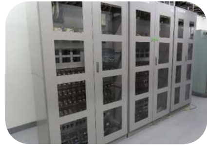
八事駅 信号設備
